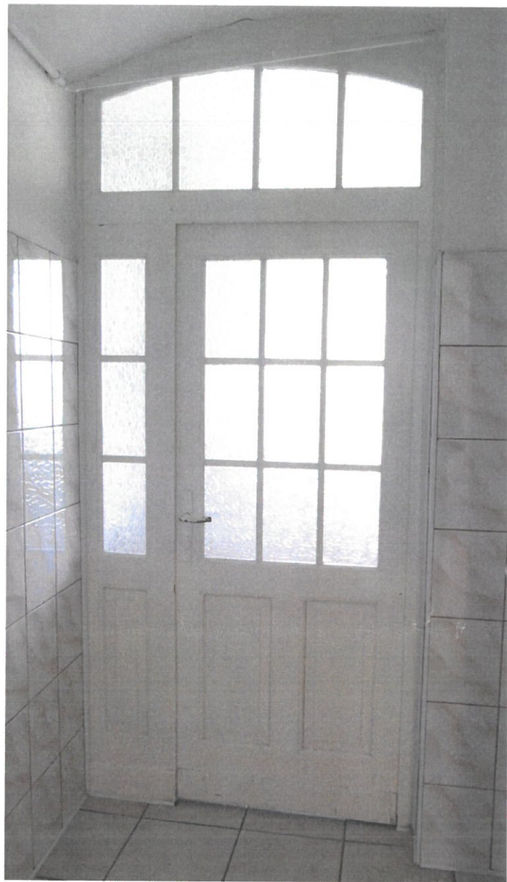
Drugie drzwi do toalety – drzwi do wymiany
