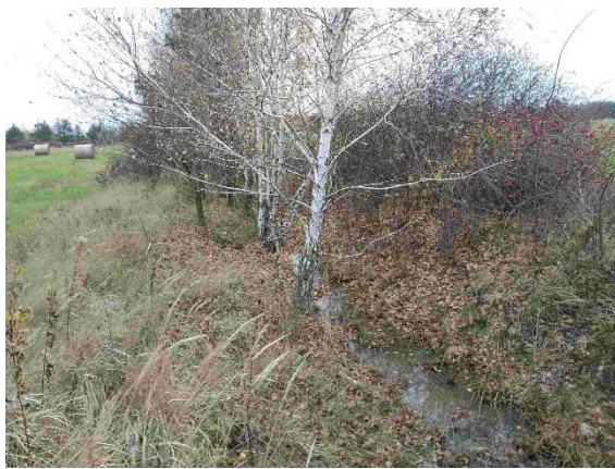
Fot. 6 Nieujawniony w EGiB rów na działce 274/4
